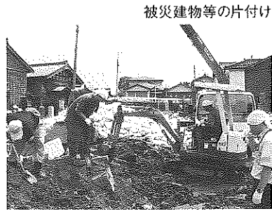
被災建物等の片付け
